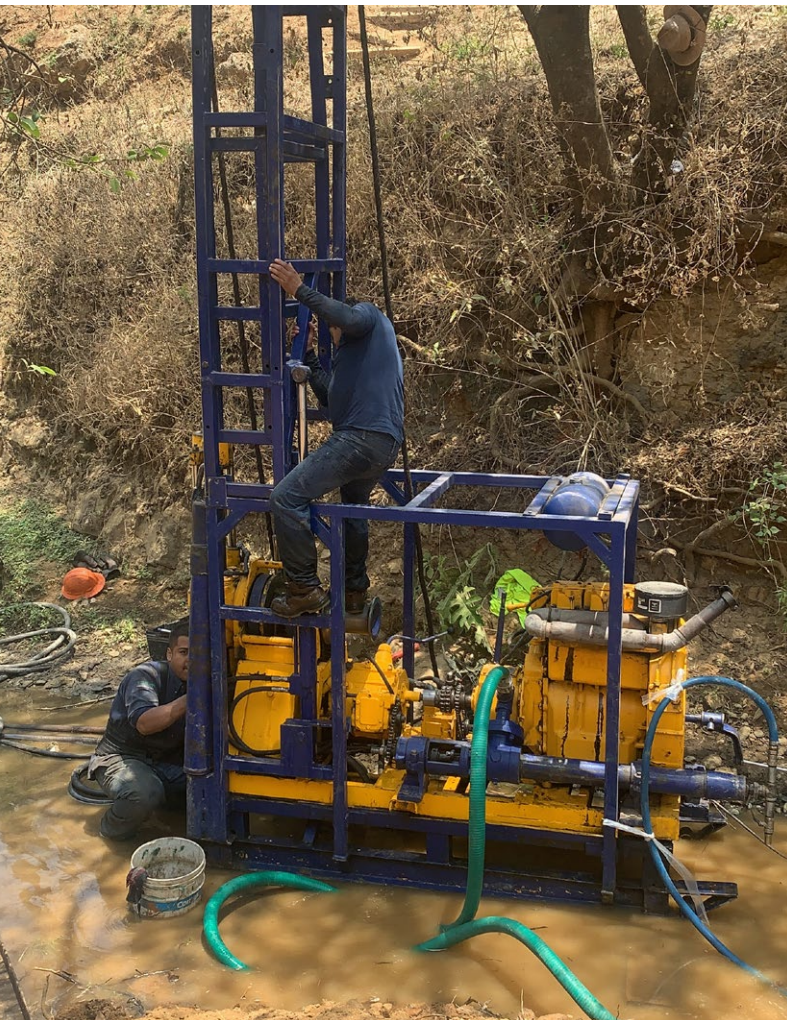
Exploración en el punto de construcción de una presa bajo tierra en la Ciudad de Oaxaca, primera contra sismos.
